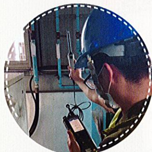
設備機房溫度檢測
