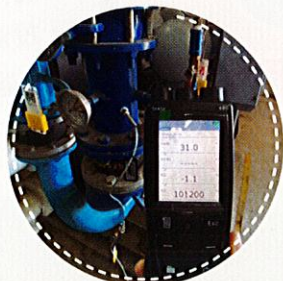
空調主機檢測
